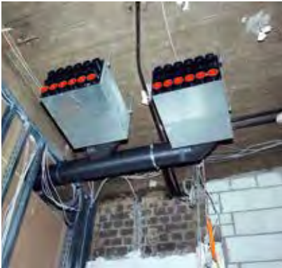
Kernstück des neuen Lüftungskonzeptes: Lüftungsanlage mit Wärmerückgewinnung.
