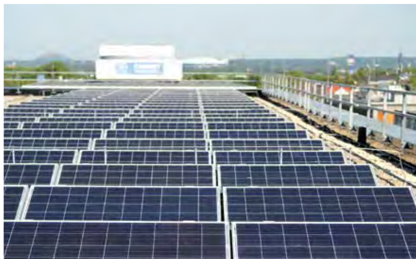
Solarkollektoren liefern Energie von der Sonne.
